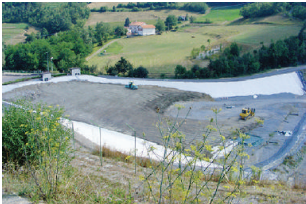
L'impianto operativo dallo scorso anno si trova in località Ferrere alla periferia di Cairo
