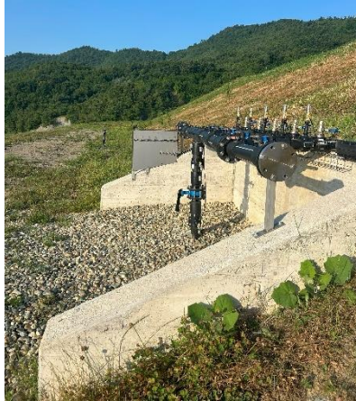
Vista e particolari di una stazione di regolazione
