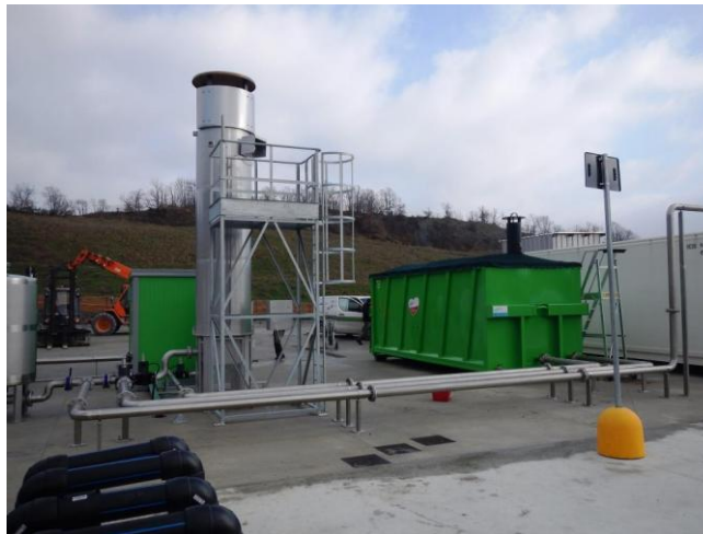
Centrale Estrazione biogas
